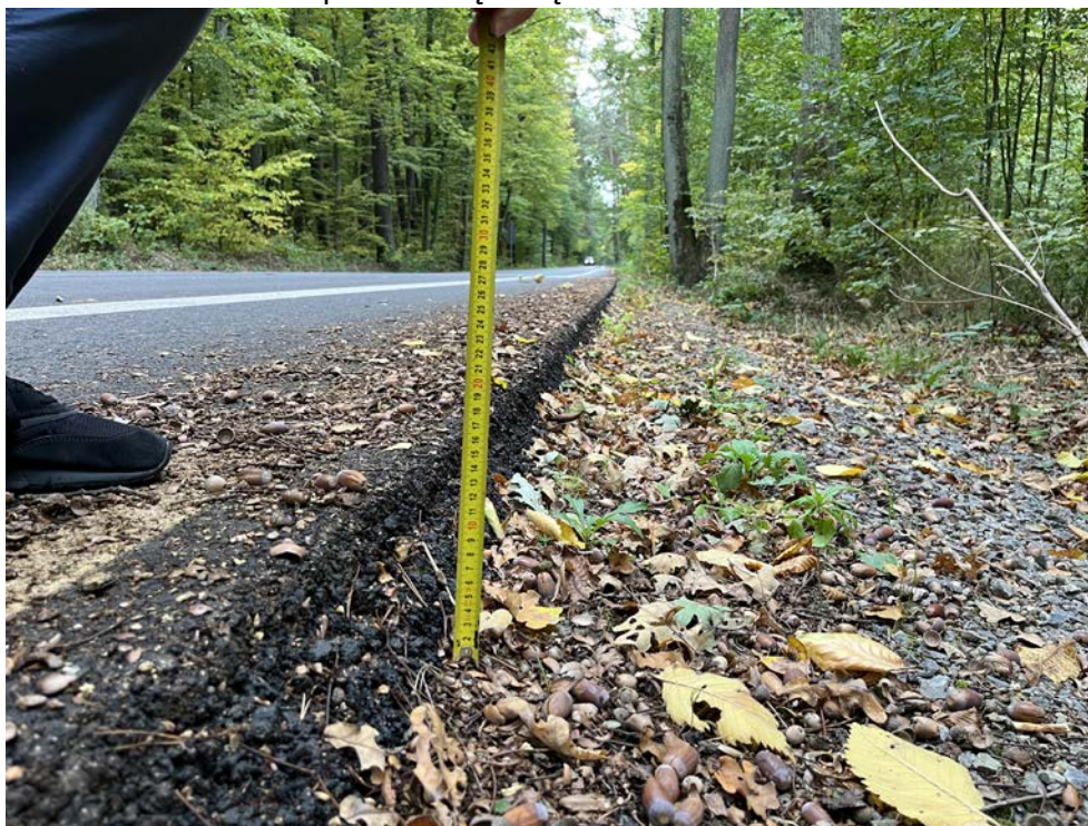
Zdjęcie 5 uskok o wysokości ponad 10 cm przy krawędzi jezdni
