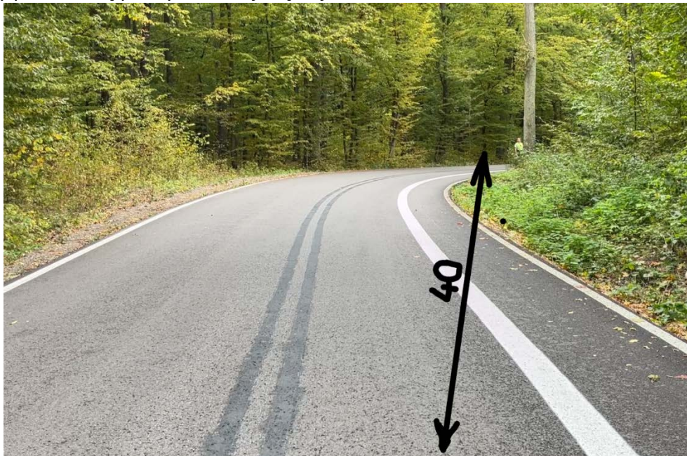
Zdjęcie 8 brak widoczności na łuku drogi
